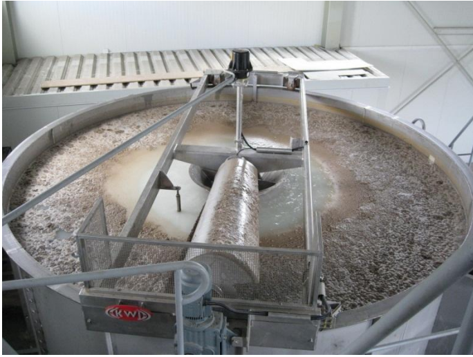
Современное водоочистное сооружение
